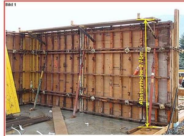
Von diesem Konsolgerüst stürzten die beiden Arbeiter auf den Betonboden. Auch der Seitenschutz fehlte.
