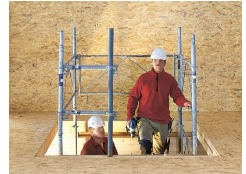
Bild 6: Treppenturm als Absturzsicherung
