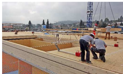
Img 5: Protezione anticaduta con rete di sicurezza e protezione bordi
