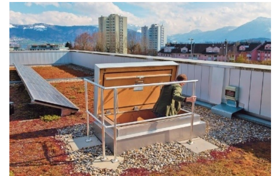
Innenliegender Treppenaufgang mit Seitenschutz und Ausstiegshilfe (Bild: Suva)
